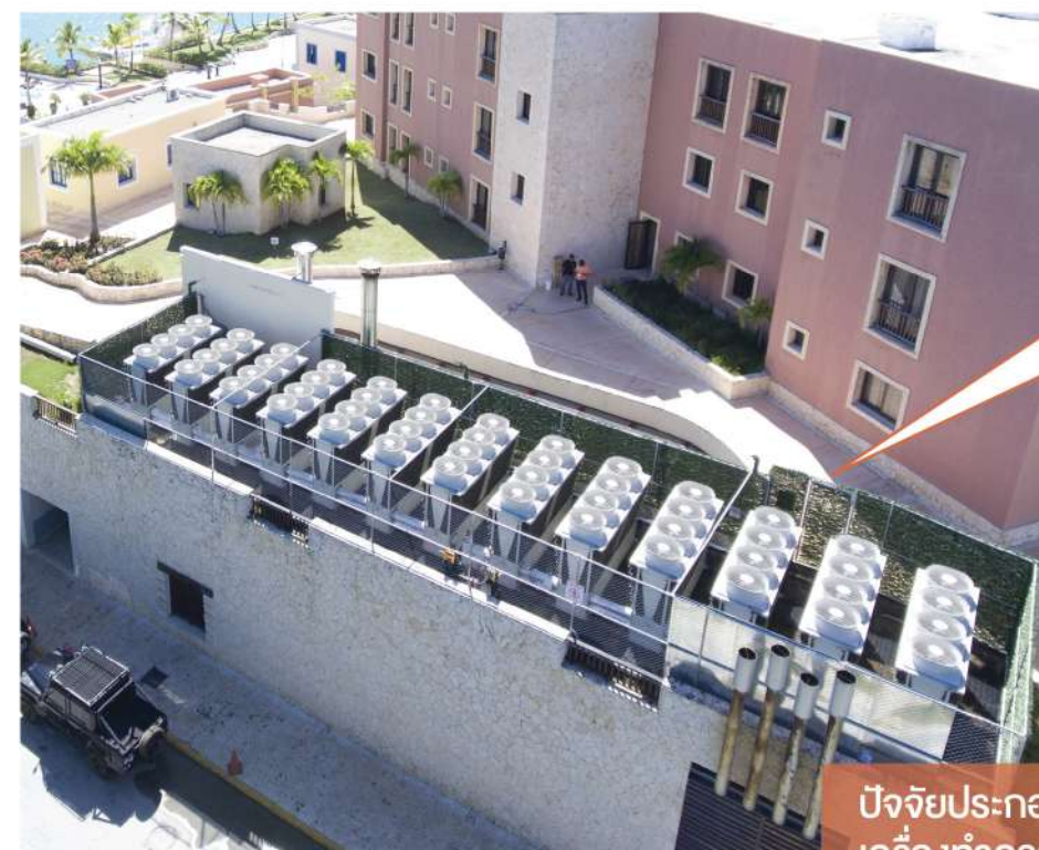
การติดตั้งบริเวณหลังคาของอาคาร เดิมเป็นพื้นที่ของหอหล่อเย็นของเครื่องทำความเย็นแบบระบายความร้อนด้วยน้ำ
