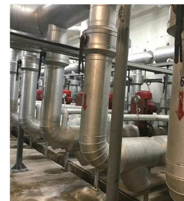
ท่อน้ำและปั๊มติดตั้งในห้องเครื่องที่อยู่ด้านหลังของหน่วย
