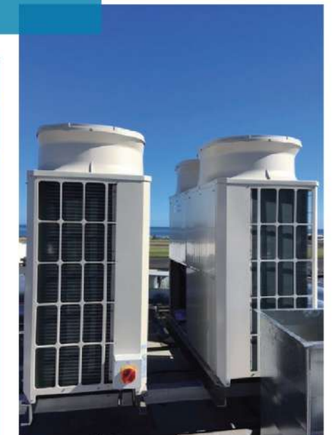
ระบบ CITY MULTI VRF สำหรับพื้นที่สำนักงานให้เช่า
